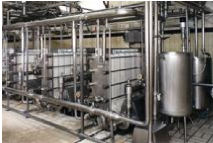
Figura 7.4 Intercambiador de placas.
